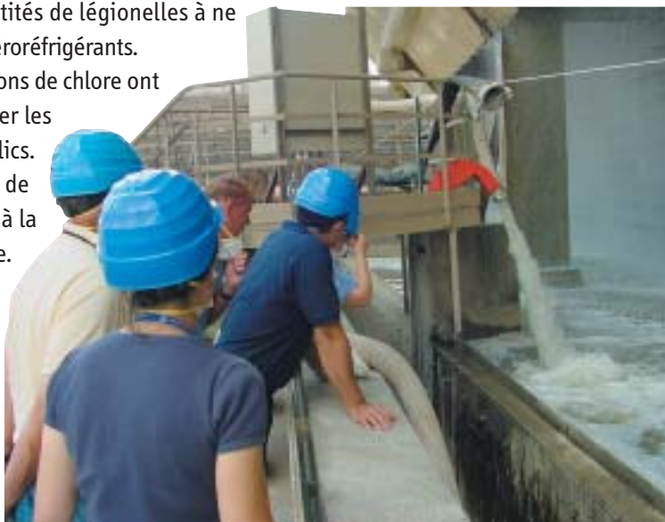
Déversement d'eau de Javel dans le bassin des aéroréfrigérants.
